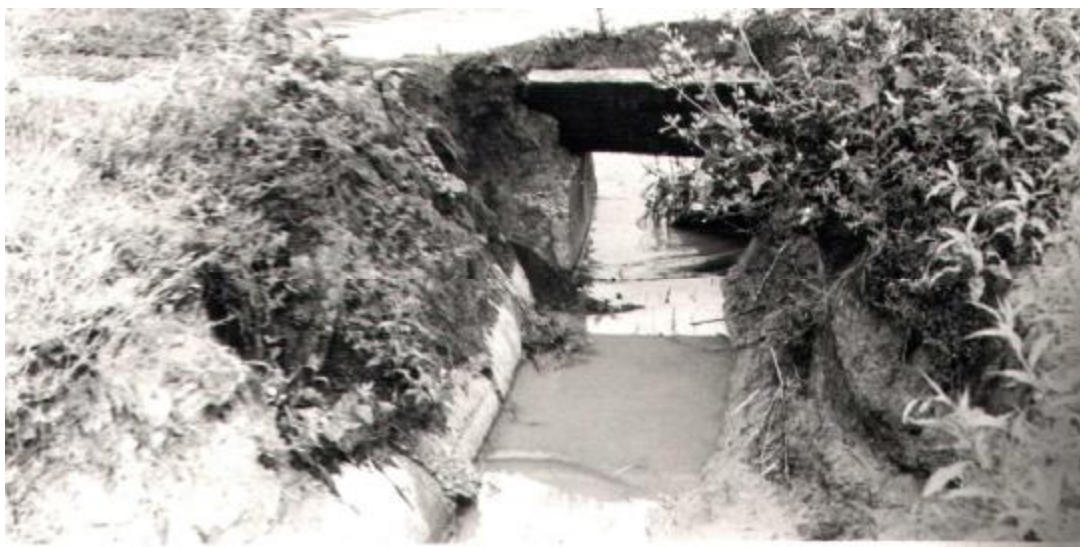
Рисунок 2 - Трубчатый переход на ПК 254 Дивенского распределителя и его состояние в период исследований
