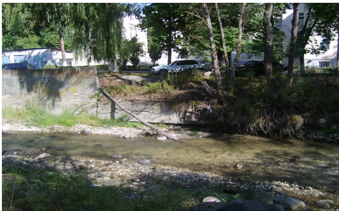
Рис. 3. Разрушенный участок прибрежного крепления р. Шалушки в районе пос. Звездное
