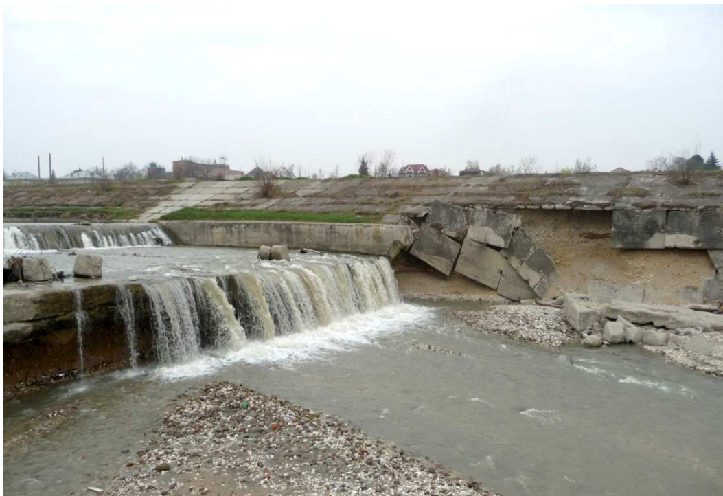
Рис. 2. Разрушенный и размывый участок нижнего бьефа железобетонного двухступенчатого перепада р. Нальчик
