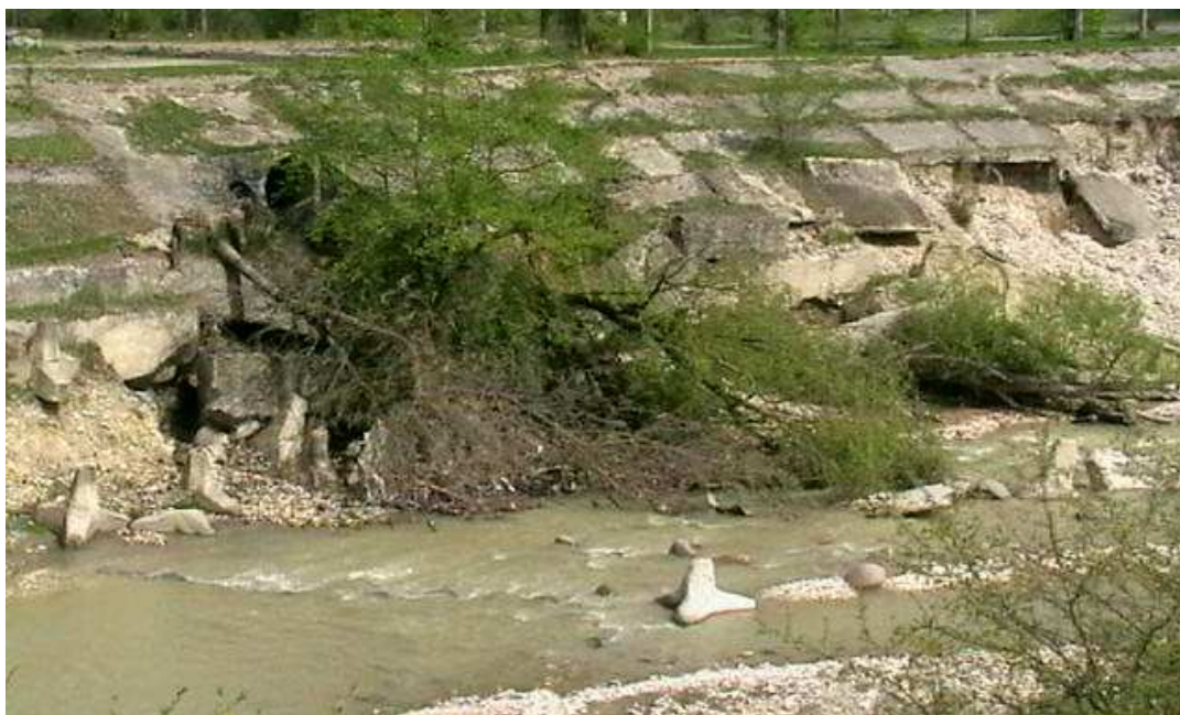
Рис.1. Разрушенный участок крепления берега р. Нальчик в результате размыва русла и фильтрационных деформаций подстилающих грунтов
